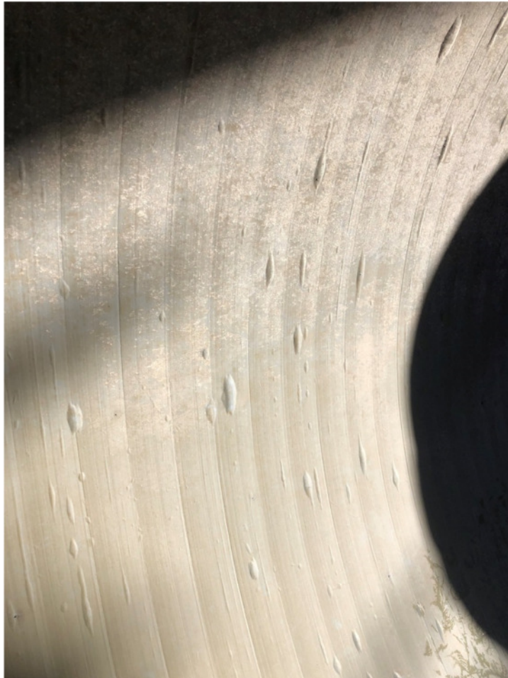
Bild: Druckleitung GFK mit Inlinerblasen
