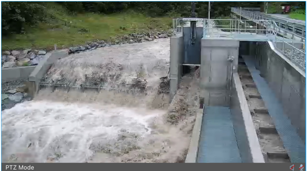
Foto: Hochwasserereignis vom 23.8.2021 mit rund 7 m 3 /s Abfluss
